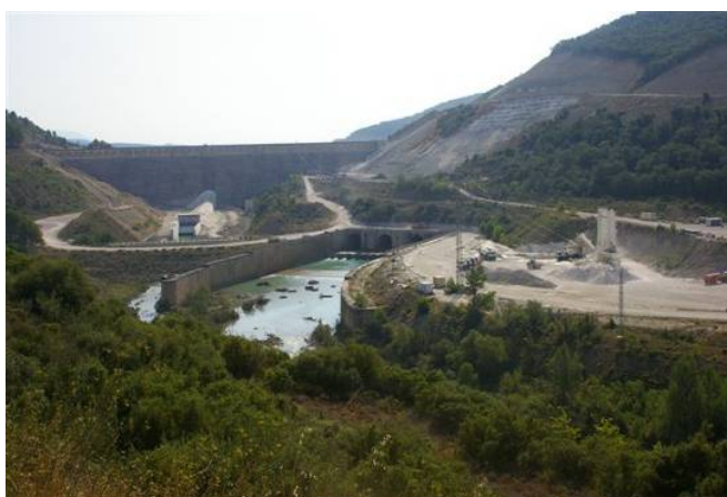
Imagen 2. Obras de recrecimiento del embalse de Yesa en la cabecera del Lugar
